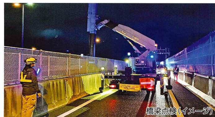
照明点検(イメージ)
